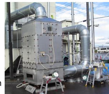
大型多孔質PTFE膜パネルを用いた排気ガス中VOC除去処理実験装置
